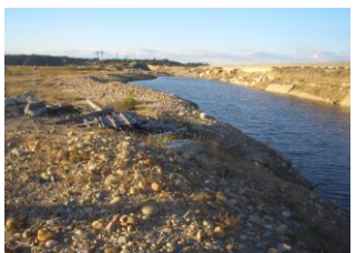
破壊された防潮堤
