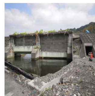
破壊された防潮堤の水門
